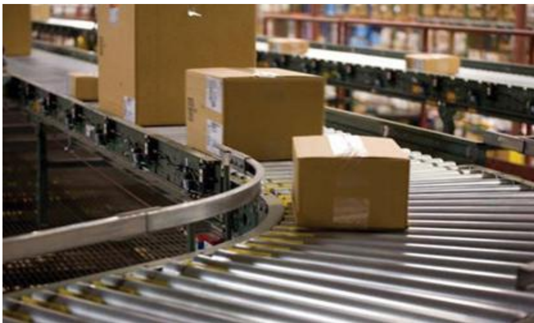
ภาพที่ 3.36 สายพานลำเลียง
