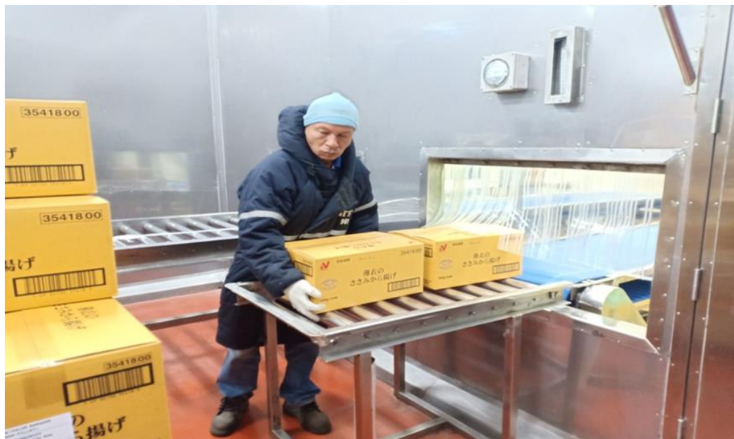
สายพานลูกกลิ้ง เพื่อนำสินค้าออกจากคลังห้องเย็น และจัดเรียงสินค้าไว้บนพาเลท
