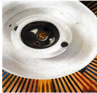
หัวต่อสายไฟ
